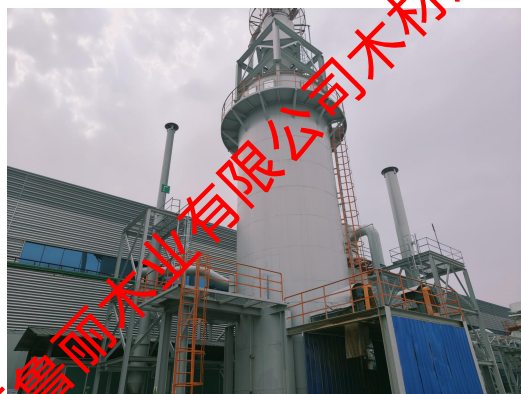
废气处理设施
