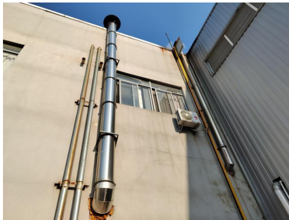
DA003 排气筒（在用锅炉废气排放口）及 DA004 排气筒（备用锅炉废气排放口）
