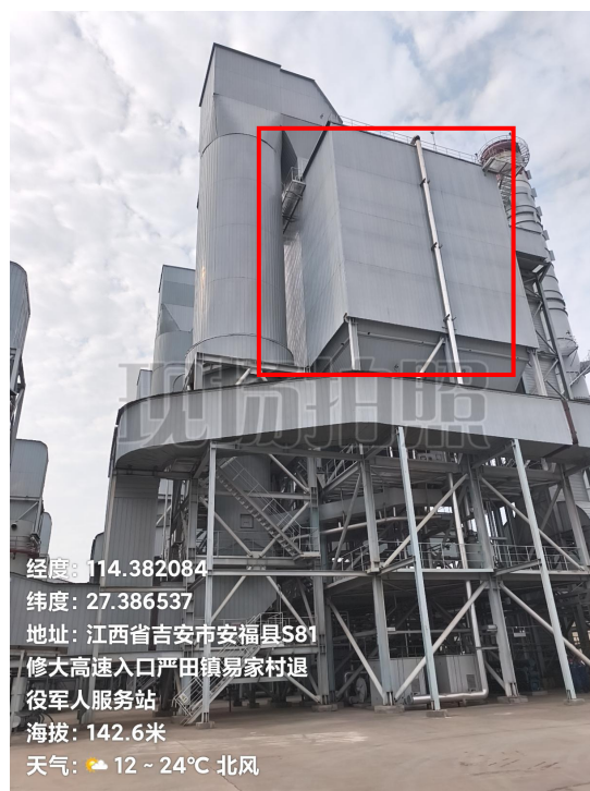
锅炉废气: 布袋除尘装置
