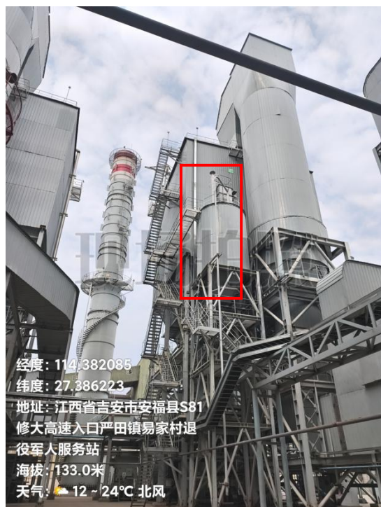
消石灰仓粉尘治理措施及排气筒（备用）
