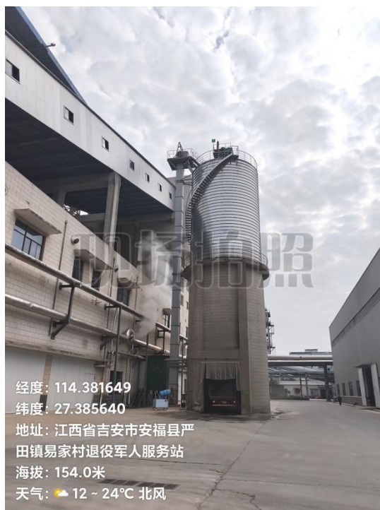
渣库粉尘治理措施及排气筒
