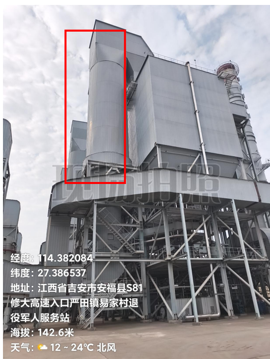
炉外半干法脱硫装置(备用)
