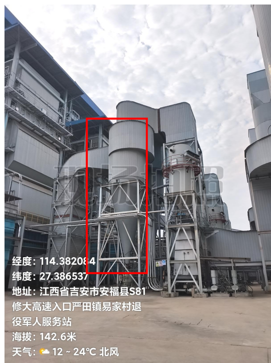
锅炉废气: 旋风除尘器
