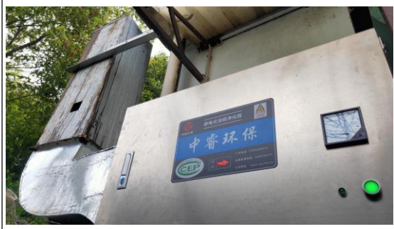
食堂油烟排气筒
