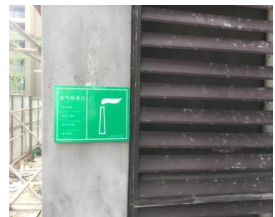
地下车库通风口
