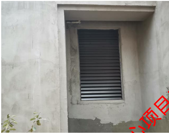
地下车库排烟口
