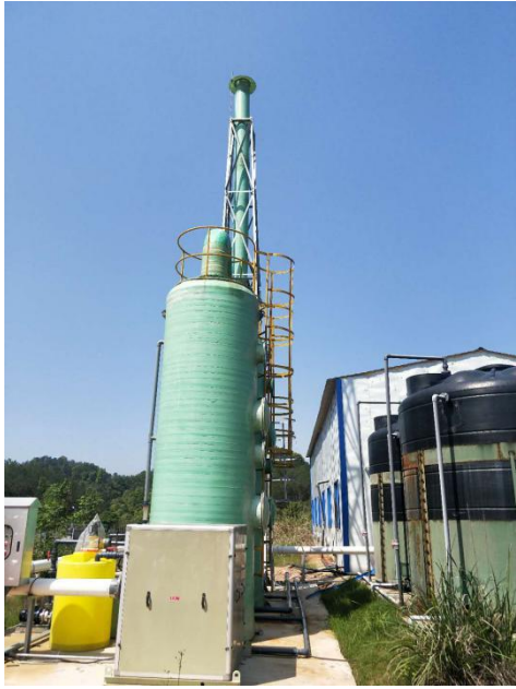
酸碱喷淋塔、排气筒
