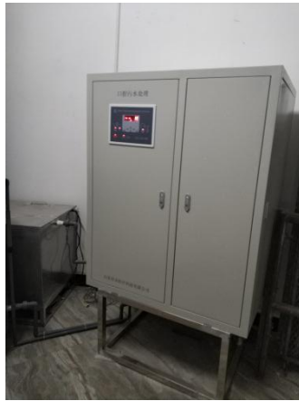
一体化口腔污水处理器
