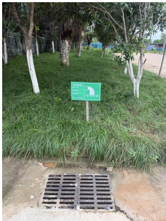
雨水排放口及标识牌
