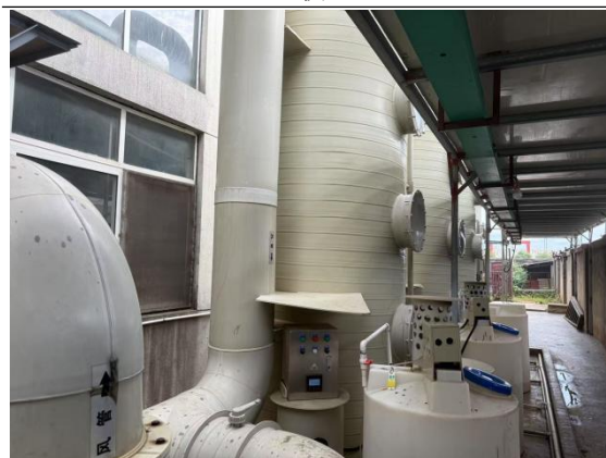
(DA003) 三级碱液喷淋吸收
