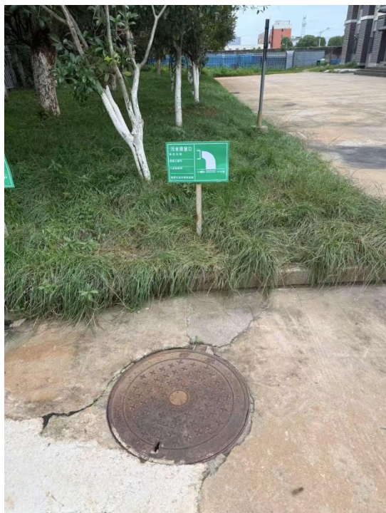
废水总排放口及标识牌
