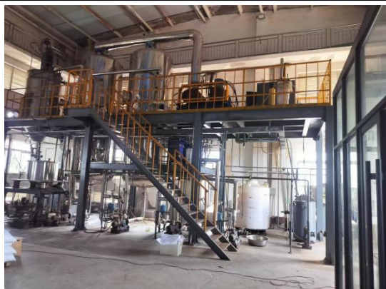
MVR 蒸发系统
