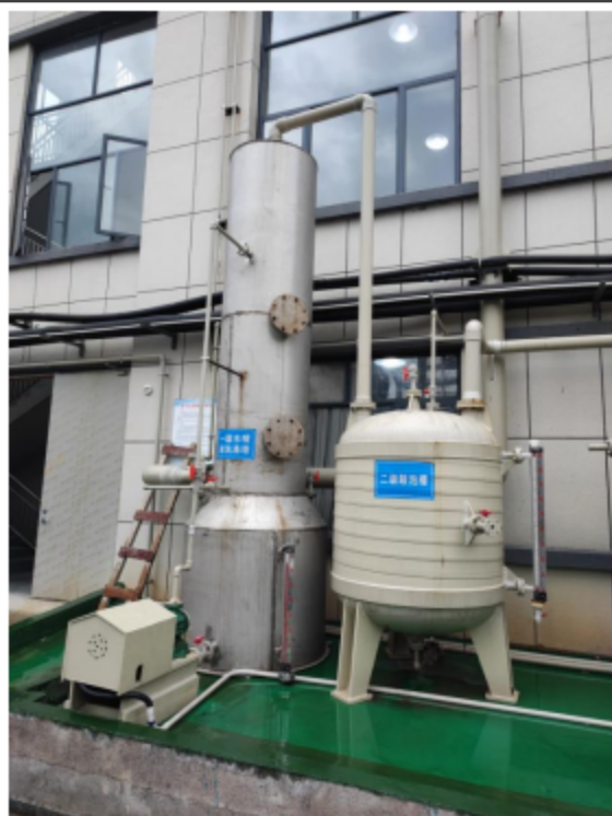
水喷淋塔+鼓泡槽
