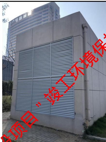
地下车库排气口
