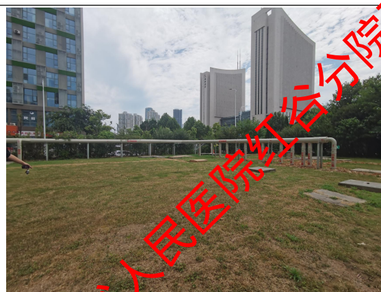
污水处理站恶臭收集管道
