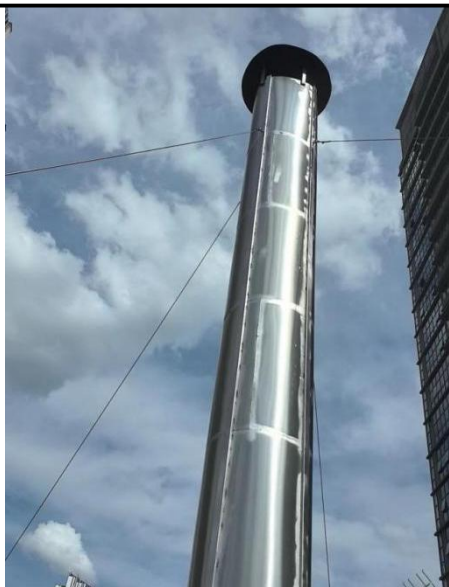
锅炉废气排气筒
