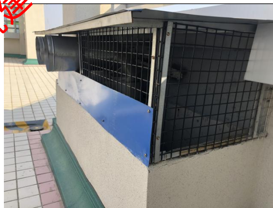
柴油发电机废气排放口
