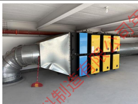
5#车间：静电除油+UV 光解净化器+一级活性炭吸附装置
