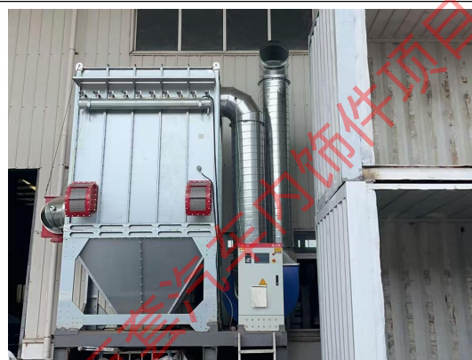
1#仓库：布袋除尘装置
