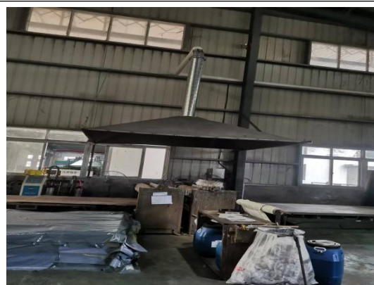
1#仓库：静电除油+UV 光解净化器+一级活性炭吸附装置
