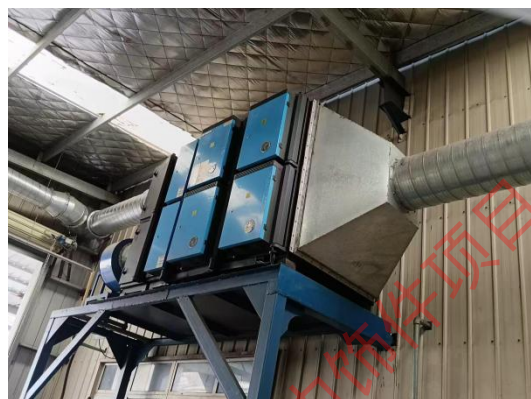
3#车间：静电除油+UV光解净化器+一级活性炭吸附装置
