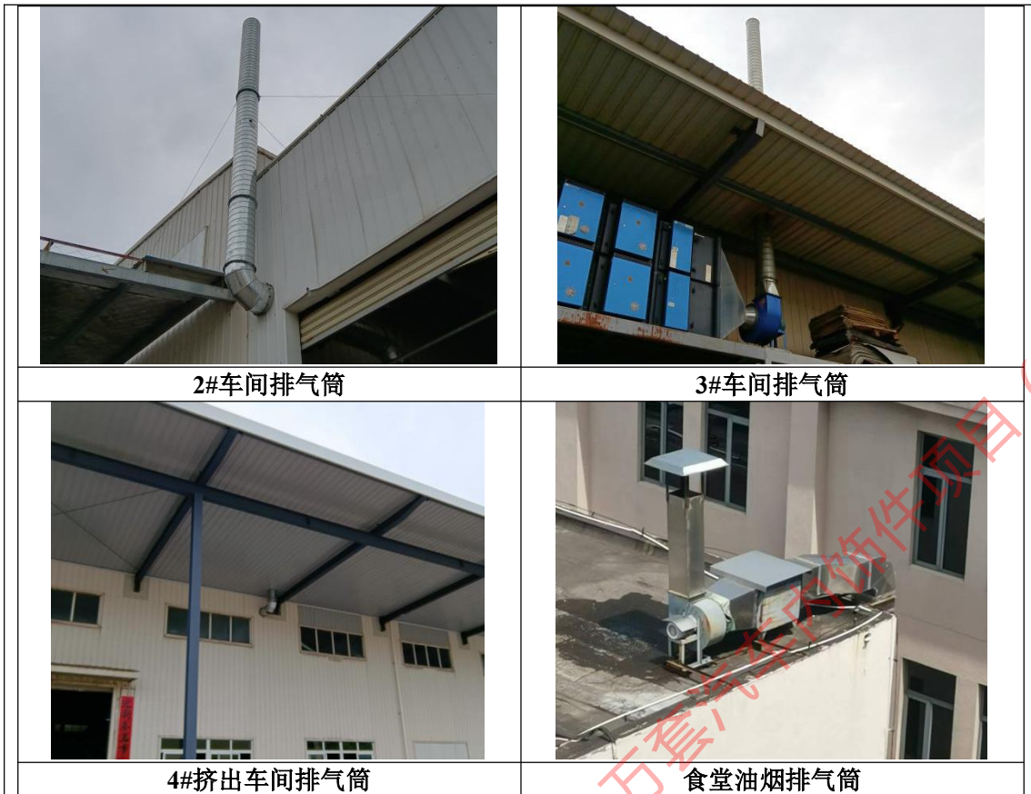
图3-2 项目废气治理设施
