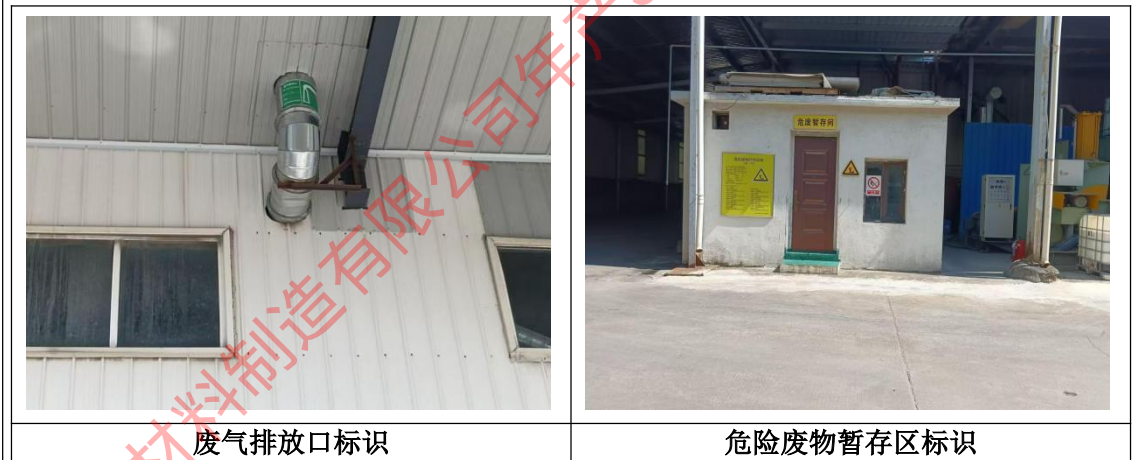
图3-5 项目排污口标识牌
