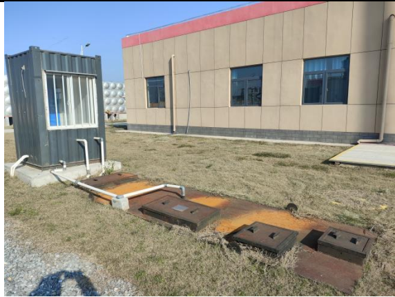
一体化污水处理设施
