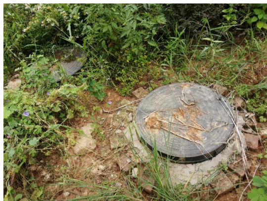
化粪池（生活污水）
