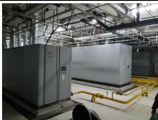
地下室锅炉房
