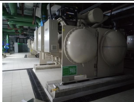
地下室空调风机
