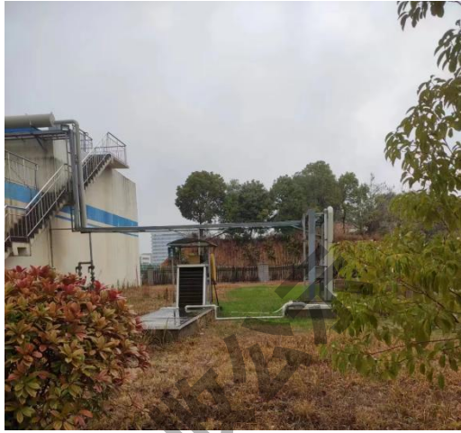
污水处理站格栅井
