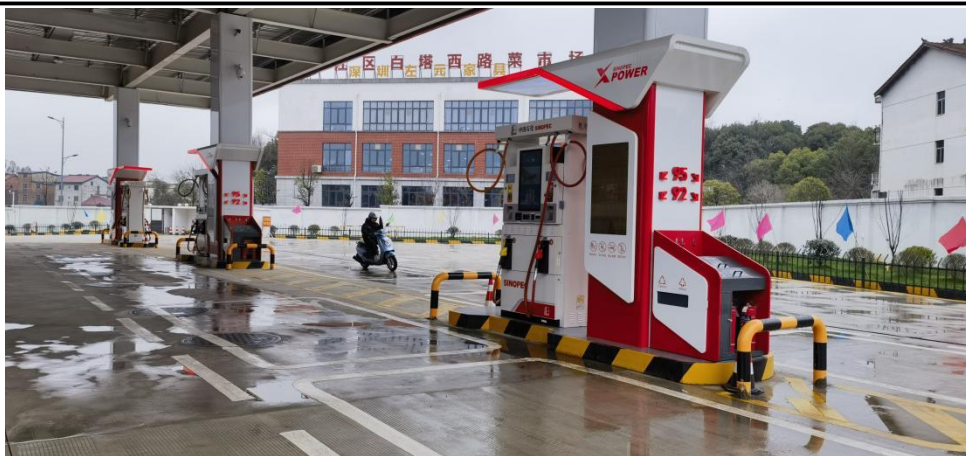
油罐区（地埋式，位于加油区地下）
