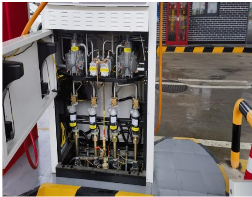
加油油气回收系统
