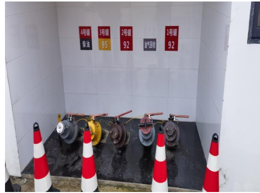
卸油油气回收系统
