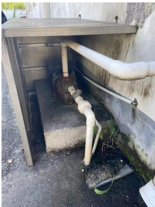
地下水抽水井
