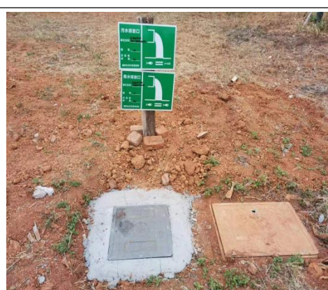
污水、雨水排放口
