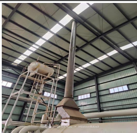
导热油炉废气排气筒
