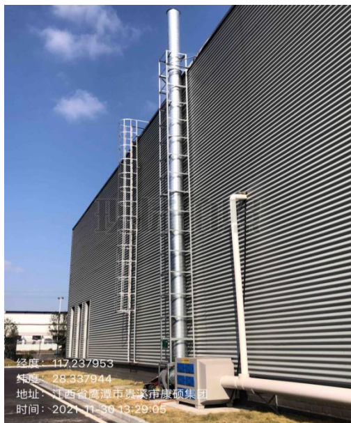
15m 高 1#排气筒
