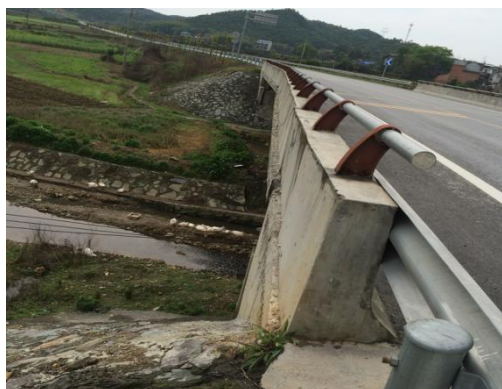
姚家中桥径流沟
