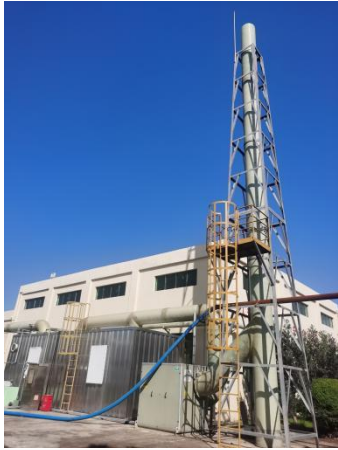
恶臭废气排放口
