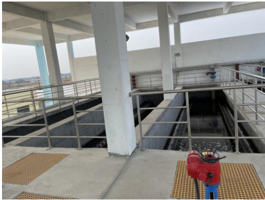
污水处理池体
