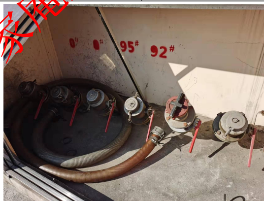
卸油口及油气回收
