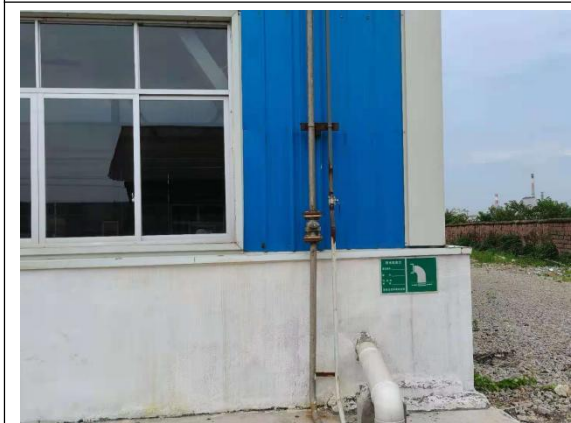
雨水排放口标识
