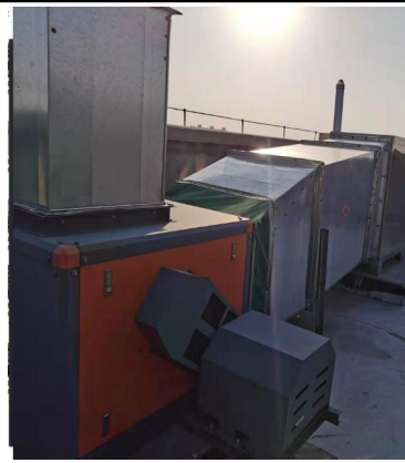
油烟净化器及食堂油烟排气筒
