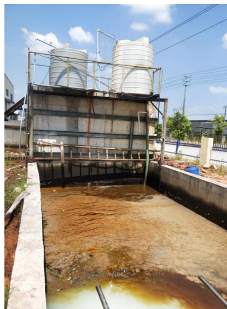
自建污水处理站
