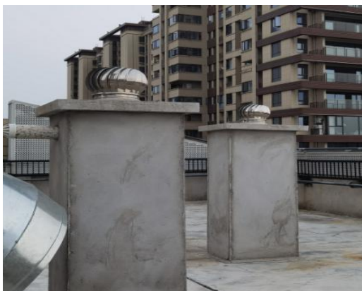
居民油烟排放口
