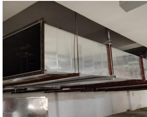
地下车库排烟管道
