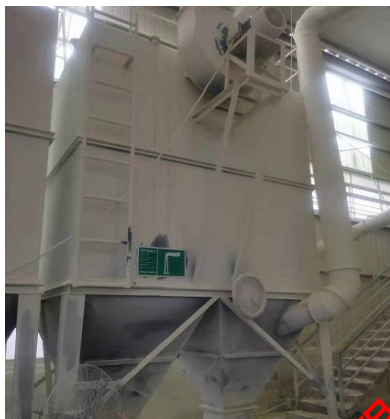
配料粉尘排气筒2#
