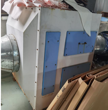
包覆废气活性炭装置（覆膜车间）
